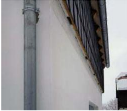
Abb. 31: Spaltenquartiere hinter Schieferverkleidung 13
