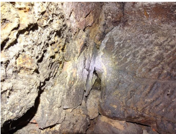
Abb. 22: Spalten im Mauerwerk der Stallung Lammgasse 15
