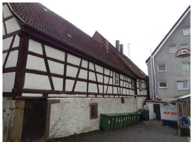
Abb. 25: Tür- und Fensterläden mit Spalten auf der Westseite von Marktstraße 40
