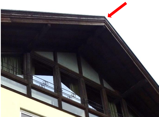
Abb. 18: Spalt im Firstbereich von Lammgasse 3 (roter Pfeil)
