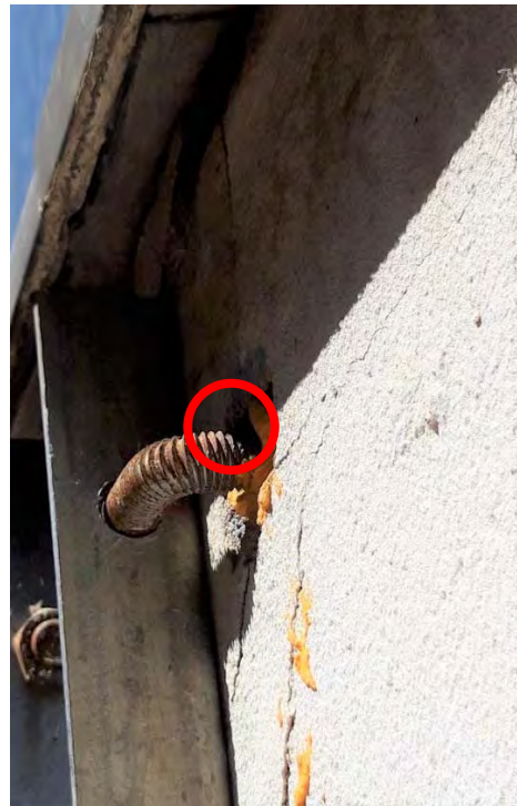
Abb. 10: ... flüchtet nach Annäherung in ein Loch in der mit PU-Schaum abgedichteten Fassade
