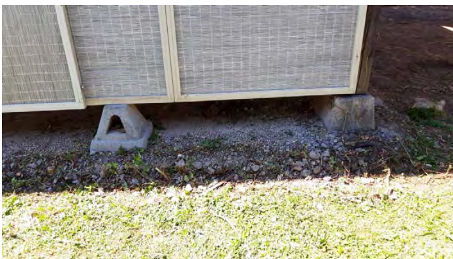
Abb. 6: Dieselbe Stelle im August 2020 – ohne Bewuchs und Balken
